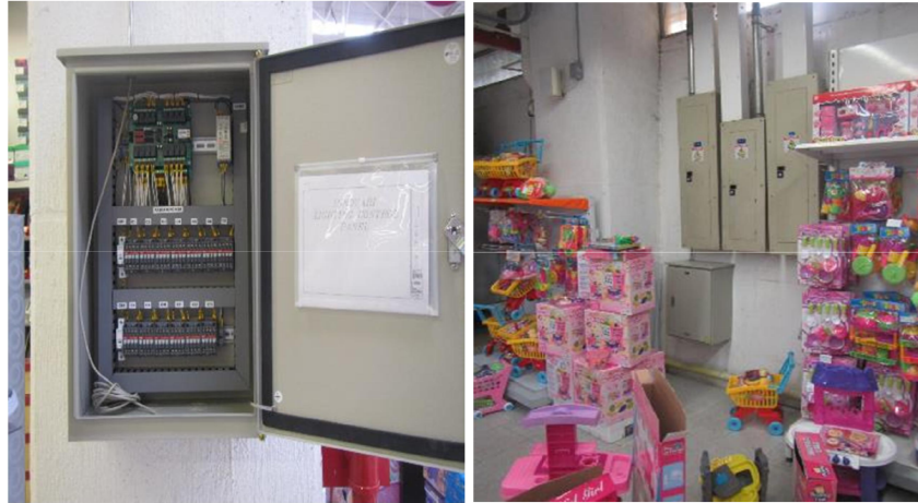
Figure 5.10: Equipos RLCP (control de luces)
