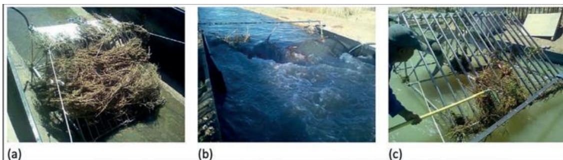
ILUSTRACIÓN 11: ACUMULACIÓN DE RAMAS Y HOJAS EN INSTALACIONES DE THCS
