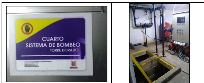
Imagen 5. Cuarto sistema de bombeo
