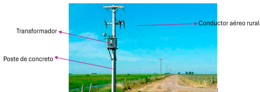
Figura 13. Activos típicos de un sistema de interconexión de OR. Fuente: Elaboración propia
