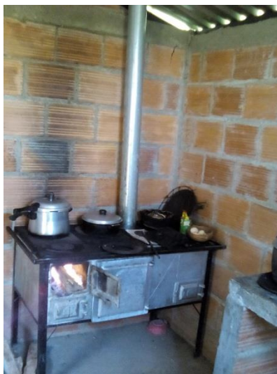
Foto 1. Estufa con plancha y chimenea
