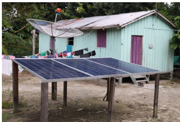
Fuente: (ENERGUAVIARE S.A. E.S.P., 2020)
