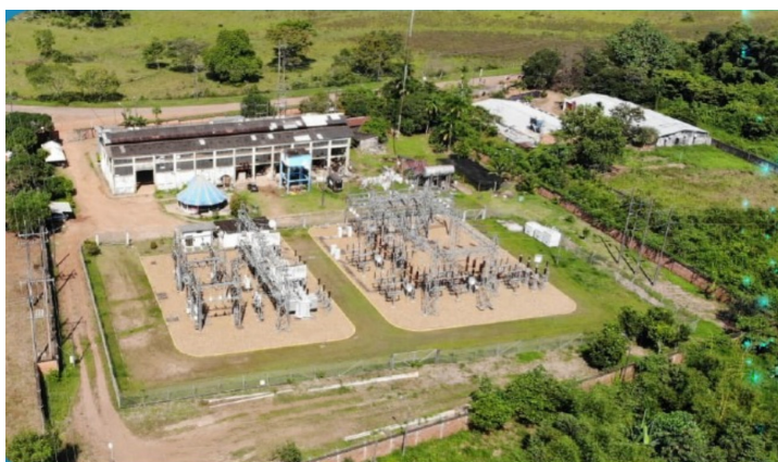
Fuente: (ENERGUAVIARE S.A. E.S.P., 2020)
