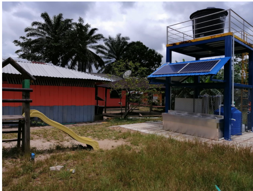
INSTALADO EN ESCUELA RURAL NUEVO TOLIMA (FOTOGRAFÍA: LGUTIÉRREZ)
