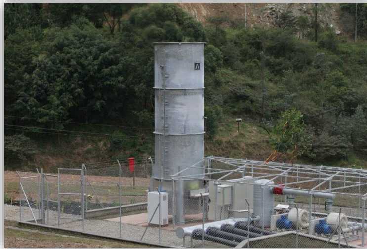
Fig.11. Sistema de captura y combustión de biogás en el relleno sanitario Curva de Rodas
