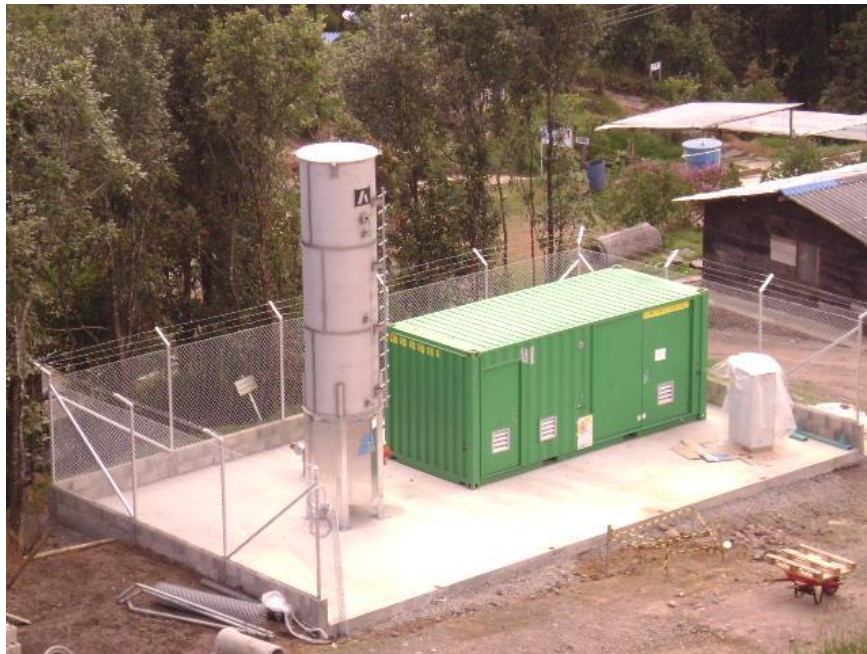
Fig.27. Planta de Desgasificación del RSA
