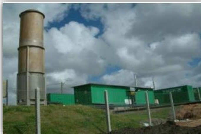
Fig.12. Planta de desgasificación y generación de energía eléctrica de las Rosas
