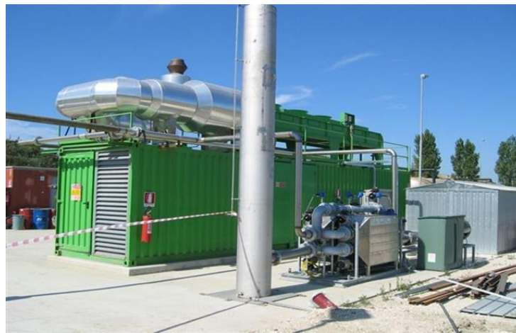
Fig.31. EQUIPO DE REMOCION DE SILOXANOS
