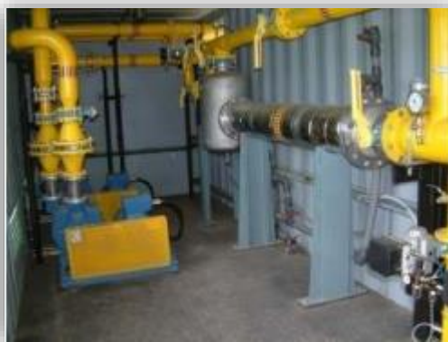
Fig.13. Central de desgasificación del Relleno Sanitario las Rosas
