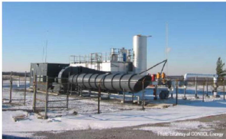
Figura 18. Instalaciones de CONSOL en Virginia que muestra un sistema de oxidación.
