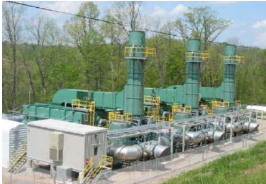
Figura 46. Oxidantes térmicos regenerativos en la mina McElroy VAM Project.
