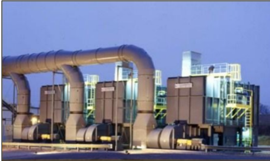
Figura 23. Oxidante Térmico Regenerativo de MEGTEC
