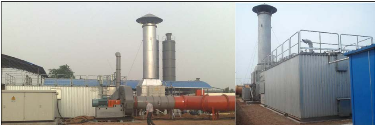
Figura 32. Montaje para VAM en proyecto Zhengzhou (UN-ECE, 2010)
