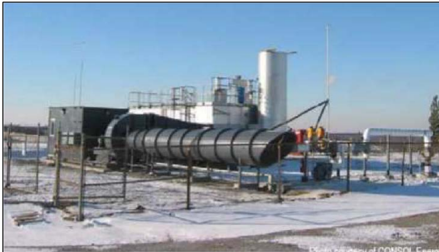
Figura 31. Proyecto VAM en mina Windsor,
