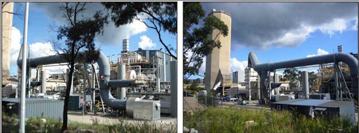
Figura 30. Instalaciones del proyecto WestVAMP
