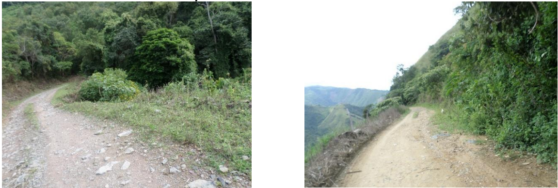
Ilustración 7 Estado Superficie de Rodadura Tramo Convención – La Mata
