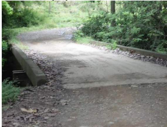
Ilustración 11 Estado de Drenajes y Obras de Arte Tramo Convención – La Mata
