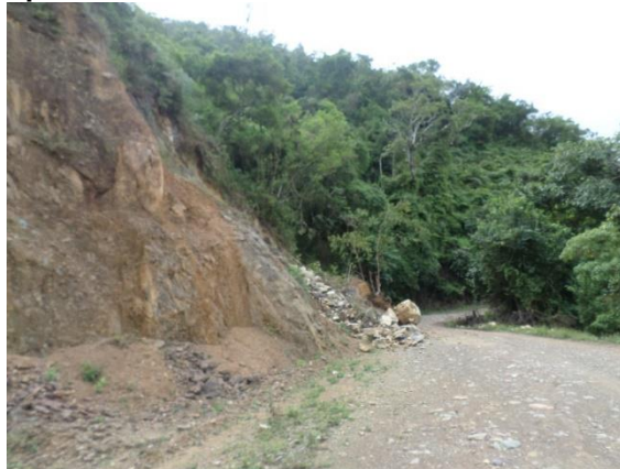
Ilustración 6 Estado Superficie de Rodadura Tramo Convención – La Mata Deslizamiento
