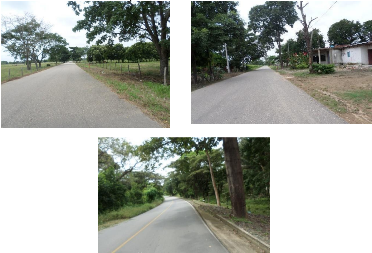
Ilustración 2 Estado Superficie de Rodadura Tramo Convención – La Mata
