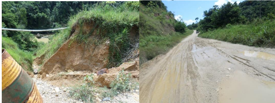
Ilustración 37 Sitios Críticos Tramo Corregimiento Orú – Astilleros
