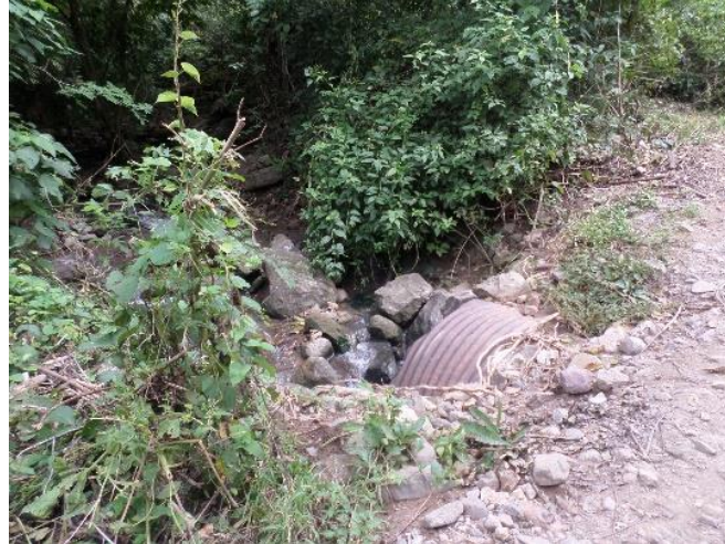
Ilustración 12 Estado de Drenajes y Obras de Arte Tramo Convención – La Mata
