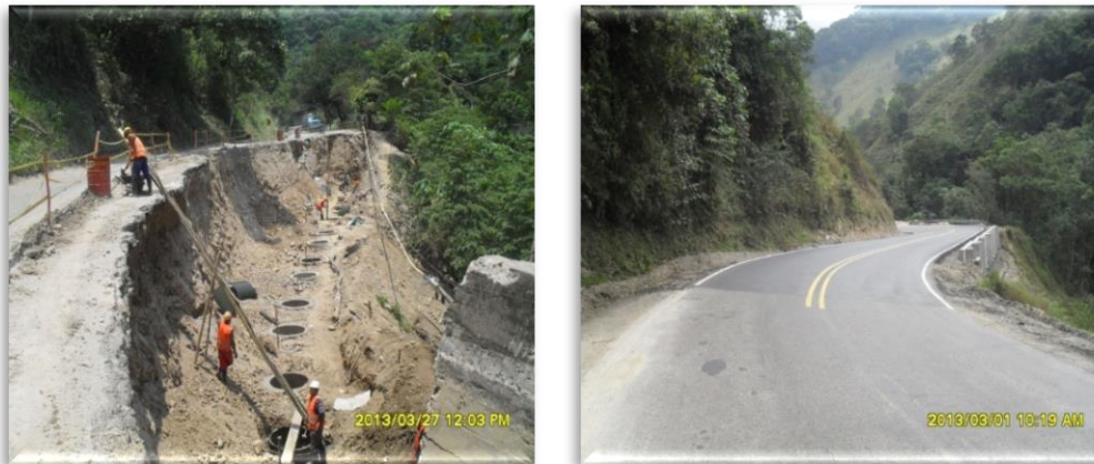
Ilustración 40. Muro de Contención Anclado PR 120+800 (Vía Ocaña-Sardinata)
