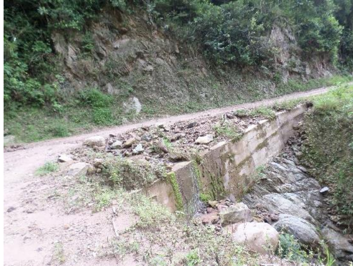
Ilustración 14 Sitios Críticos Tramo Convención – La Mata K14+600
