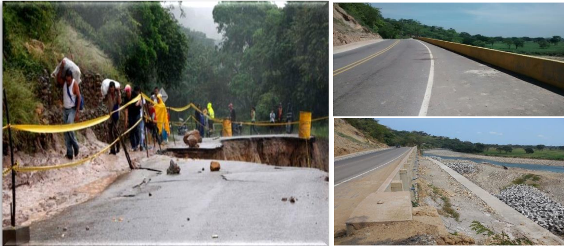
Ilustración 41. Muro de Contención Anclado PR 36+200 (Sardinata-El Zulia)
