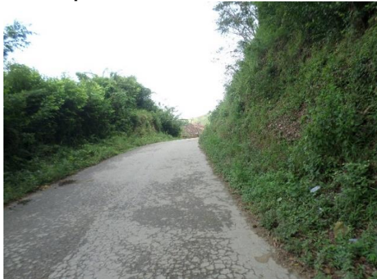
Ilustración 3 Estado Superficie de Rodadura Tramo Convención – La Mata
