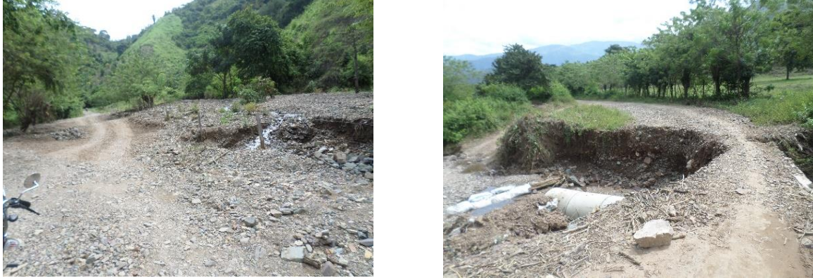
Ilustración 13 Sitios Críticos Tramo Convención – La Mata K58+600
