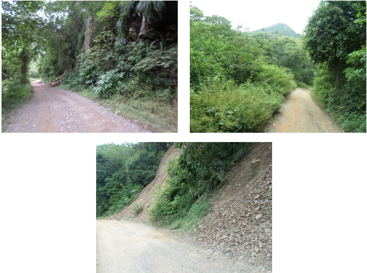
Ilustración 9 Estado Superficie de Rodadura Tramo Convención – La Mata
