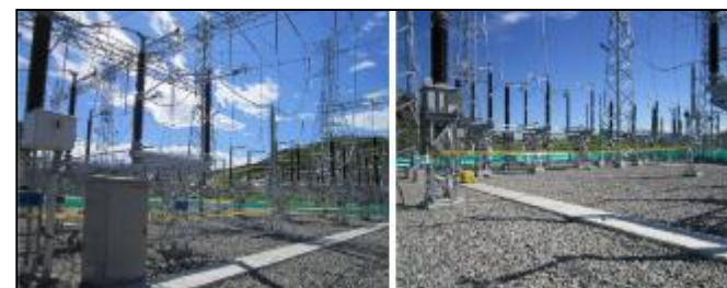
Subestación Tesalia 230 kV
